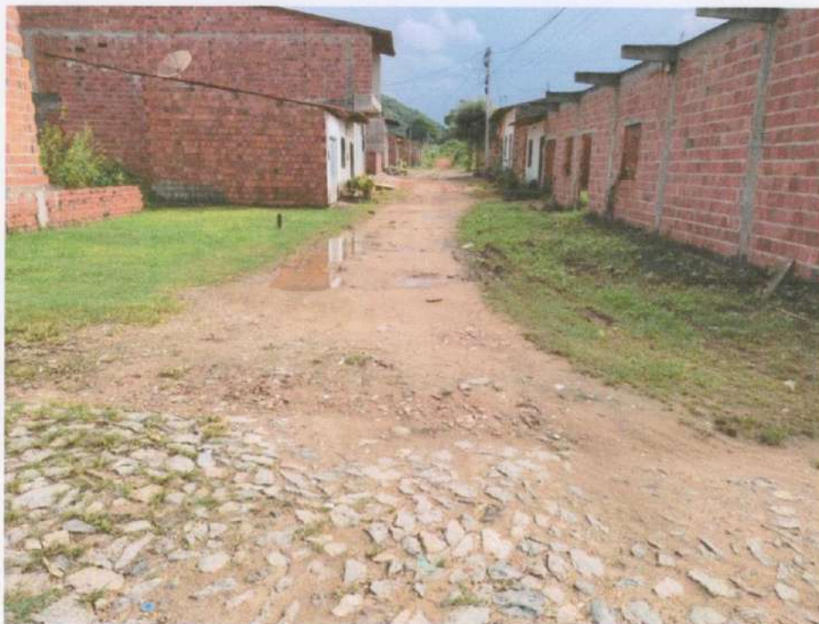
Foto 01 – Rua SDO 03 – Próximo ao Estádio 24M | 442855.65 m E | 9599900.59 m S
